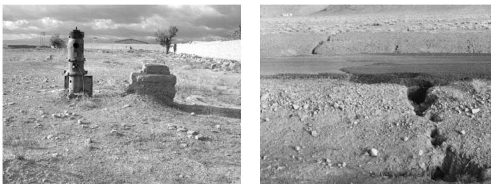
شکل ۱۰- لوله‌زایی و ایجاد شکاف در اثر نشست زمین در شمال‌غربی دشت مشهد شرکت آب منطقه‌ای خراسان رضوی (پائیز ۱۳۸۴).
