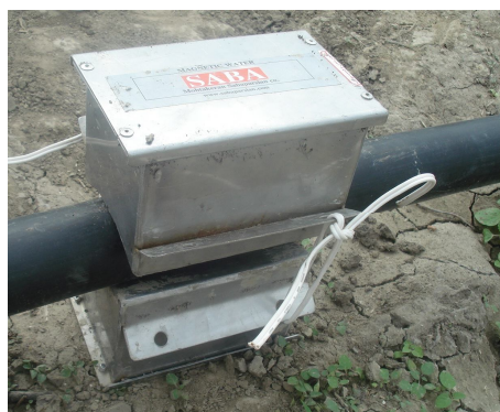
شکل ۱- دستگاه مغناطیس نصب شده بر روی لوله.
